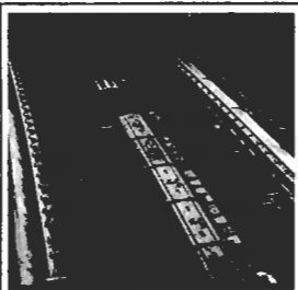
Une petite partie de l'immense anneau de l'accélérateur géant de Serpoukhov (70 Gev) dont le professeur Barwich vit le début de construction alors qu'il était sous-directeur du laboratoire de Doubno, de 1961 à 1966
