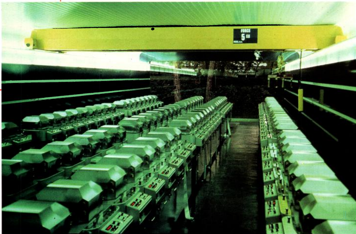
Figure 10 ▲ Salle des 100 compteurs BBF du SCPRI
