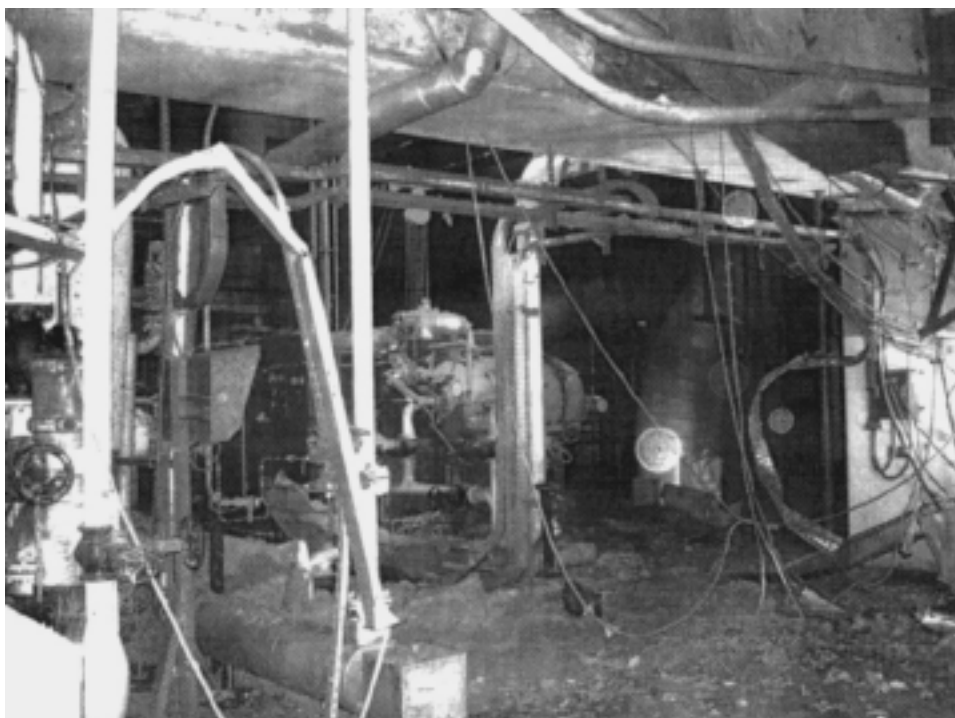
Attentat ? non, salle des machines de la tranche 2 de Nogent-sur-Seine, après explosion de la tuyauterie GCA.
