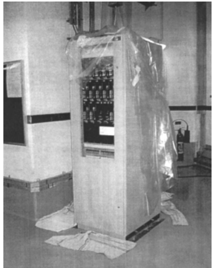
Nogent-sur-Seine, armoire électrique et sa protection contre les inondations, bâche en plastique transparent sur le dessus et serpillières au pied.
