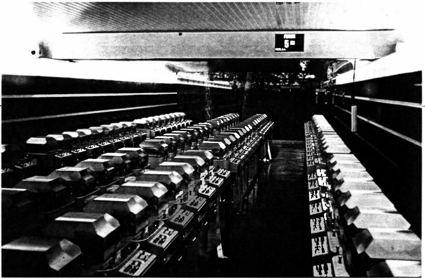
Figure 10 ▲ Salle des 100 compteurs BBF du SCPRI
