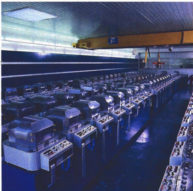
LA SALLE DE 100 COMPTEURS A FAIBLE MOUVEMENT PROPRE
